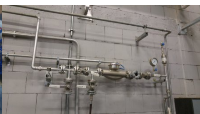
Instalacja masowa do oleju opałowego
