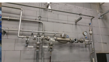
Instalacja masowa do oleju opałowego
